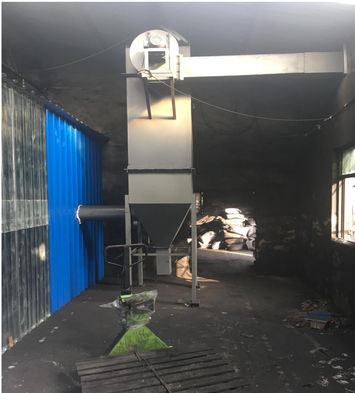
图5.2-1 废气处理设施
